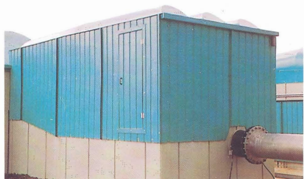
Einhausung eines Sandklassierers auf Edelstahlkonstruktion mit Schlupftür und Dachrinne
