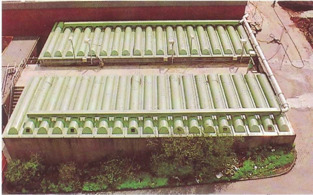
Kompostwerk Duisburg-Huckingen: Spannweite 7,50 m mit GFK-Entlüftungsleitungen bis zum Edelstahlanschluß
